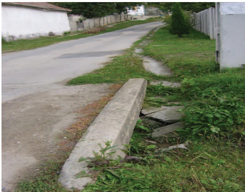
Felújításra vár a felszíni csapadékvíz elvezetés (2006.)
